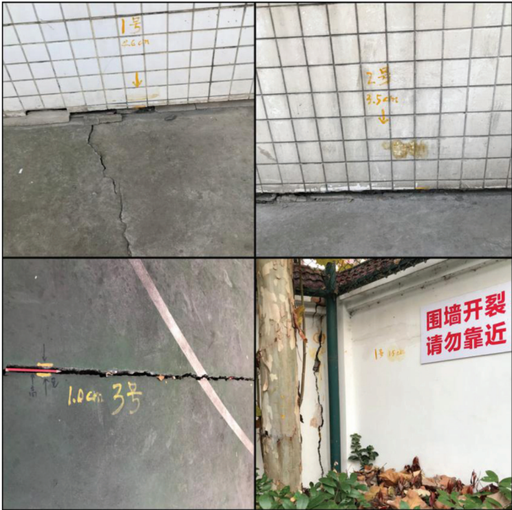
图3 研究区内沉降开裂情况
