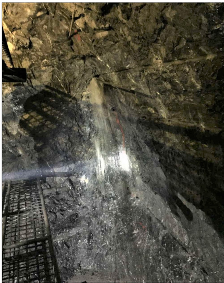
图 4 掌子面涌水现场照片
