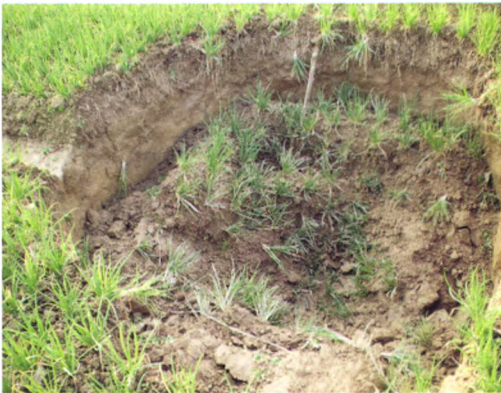
照片 1 18 号墩右侧约 50 m 塌陷坑
