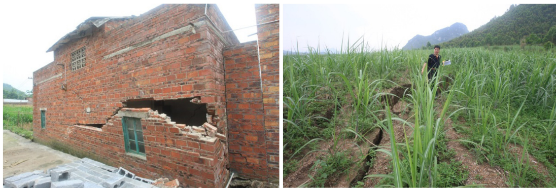
图6 塌陷造成的房屋破坏和地裂缝
