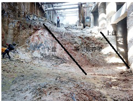
图 4 基坑内出露断层
