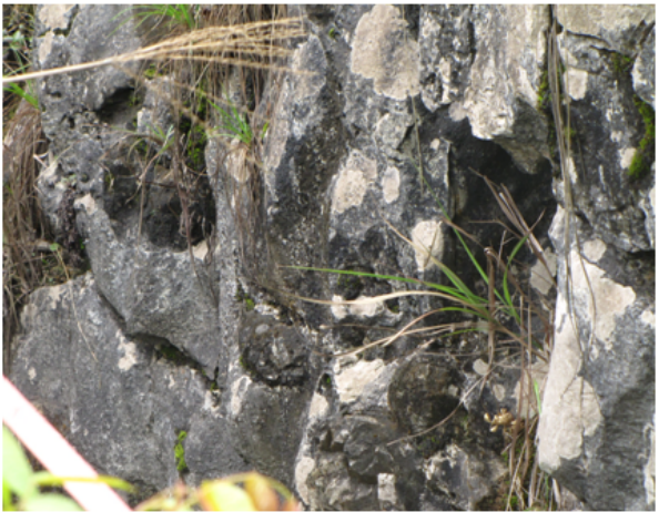
图 2 裂缝严重溶蚀
