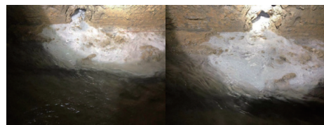
图4 梁家坡隧道排水管现场结晶情况
