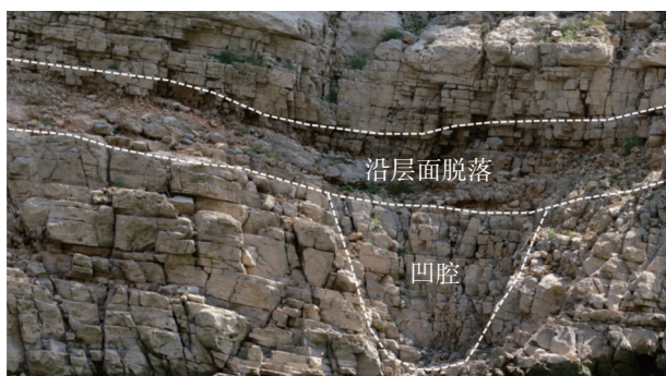
图4 大宁河段机械侵蚀劣化现象
