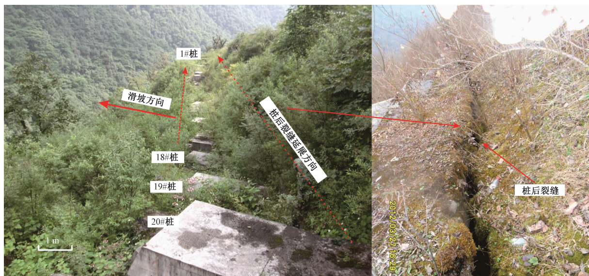
图 3 二郎山 1#滑坡 1#~20#桩后深长裂缝
