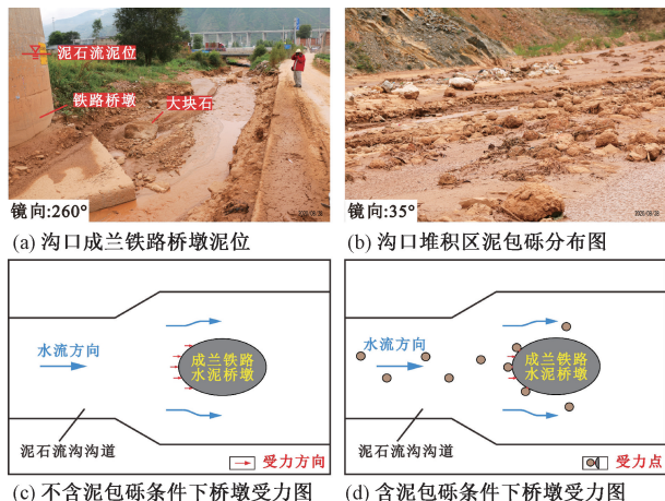
图 10 浑水沟沟口处泥石流泥位、泥包砾堆积及成兰铁路桥墩受力分析
