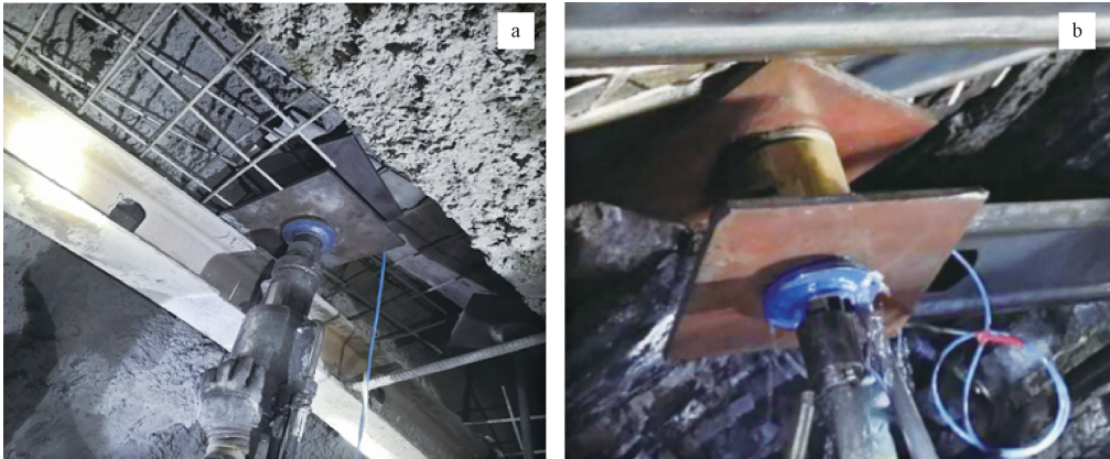
a—右拱肩锚索受力监测; b—拱顶锚索受力监测
