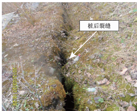
图1 二郎山1#滑坡治理工程桩后裂缝
