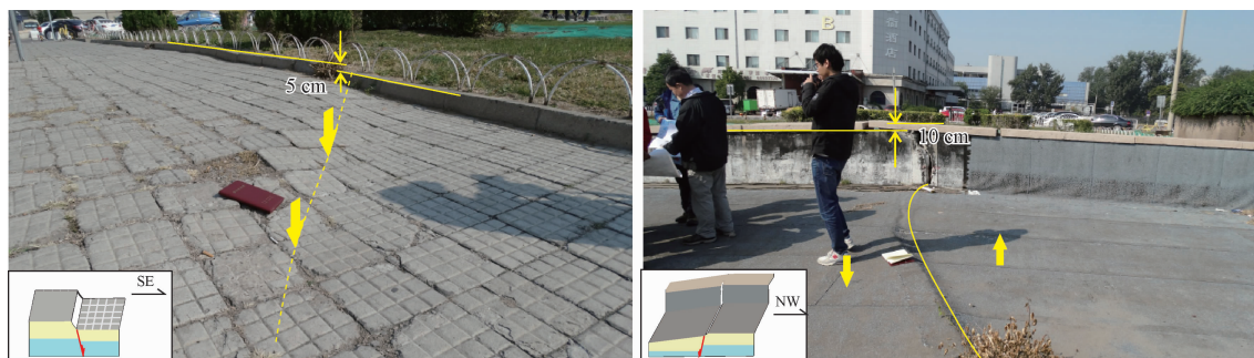
图10 顺义机场地裂缝地表陡坎
