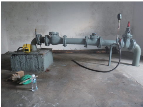
图3 地面沉降导致的管道一侧抬升
