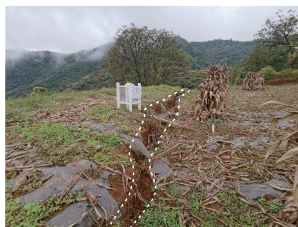
(a) 滑坡中部贯通拉张裂缝
