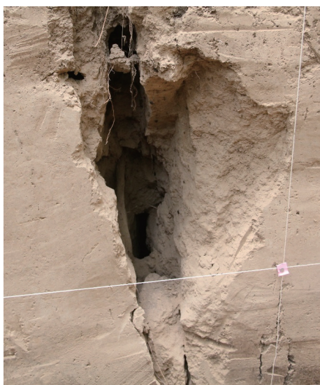
图 3 探槽揭示的地裂缝局部拉张现象
