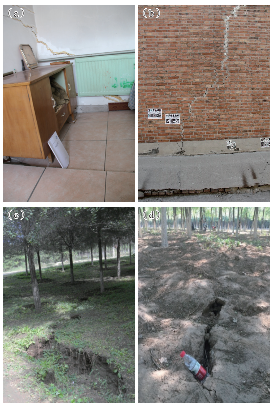
图 2 地裂缝造成的墙体和地表破坏现象
