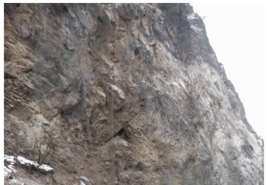
图 13 老虎嘴路段上边坡干溶洞(隙)
