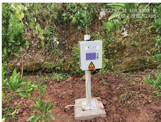
(b) 坡倾仪设备现场实物
