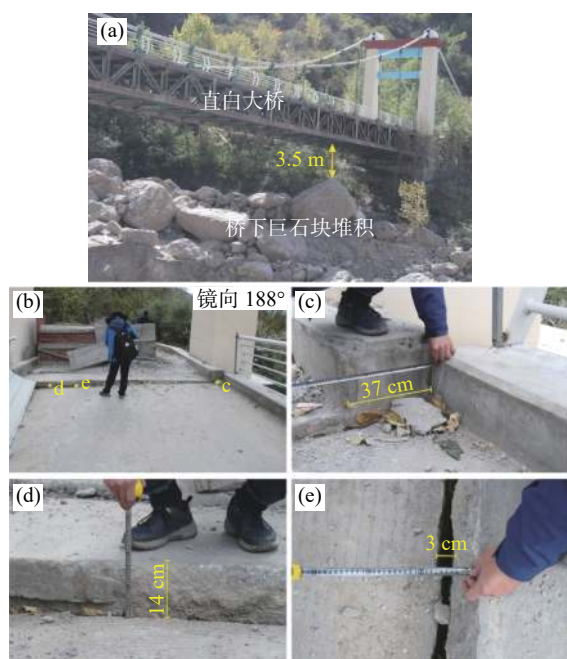
图 1 直白大桥受损特征 (拍摄于 2020 年 10 月)
