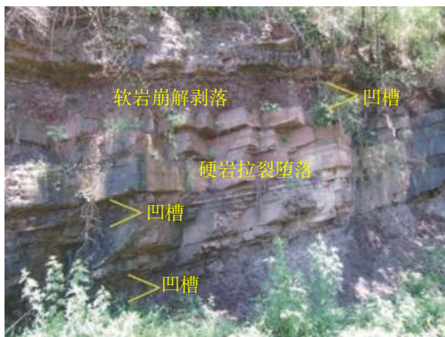
图 10 差异风化形成的凹槽
