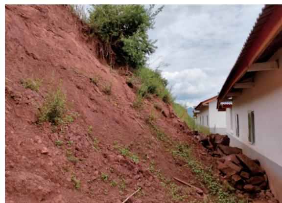
图 2 切坡建房引发的滑坡
