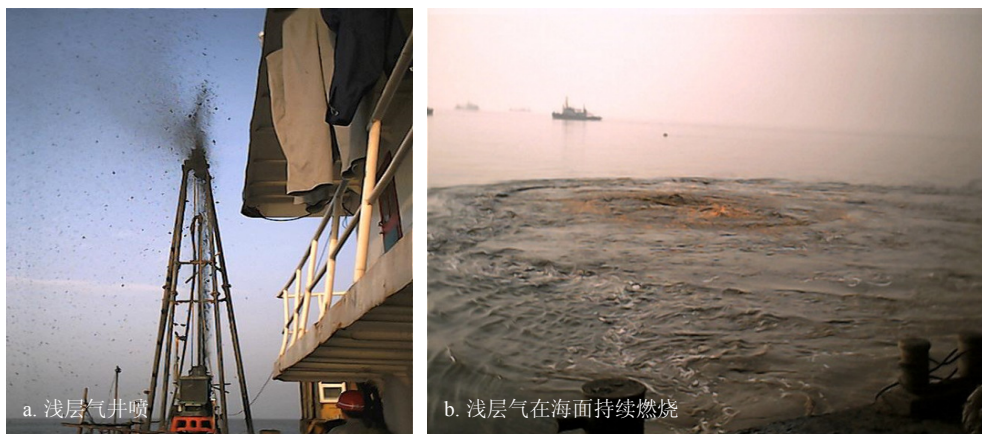
图 8 杭州湾工程地质勘察过程中浅层气灾害事故 [77]
