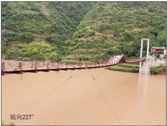
图 6 桥面大面积隆起(2019 年 7 月 9 日) Fig. 6 Large area uplift of bridge surface (July 9, 2019)
