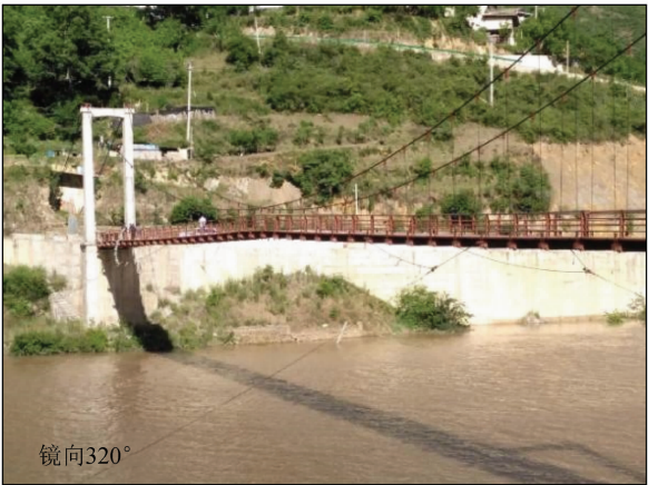
图 5 早期桥面隆起(2019 年 6 月 13 日) Fig. 5 Early stage of bridge surface uplift (June 13, 2019)
