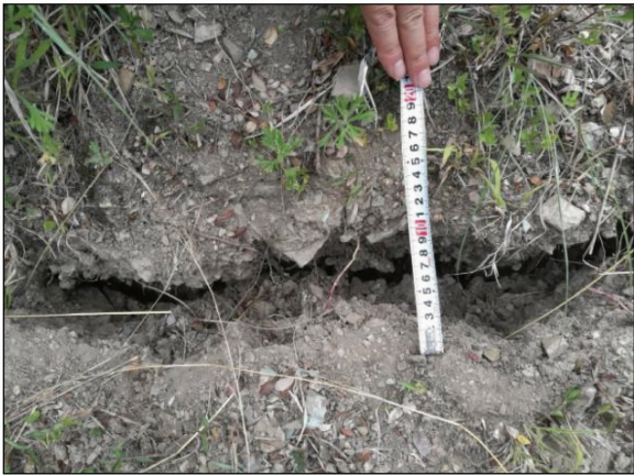
图 3 滑坡后缘裂缝(2019 年 6 月 13 日) Fig. 3 Crack on the back edge of landslide (June 13, 2019)
