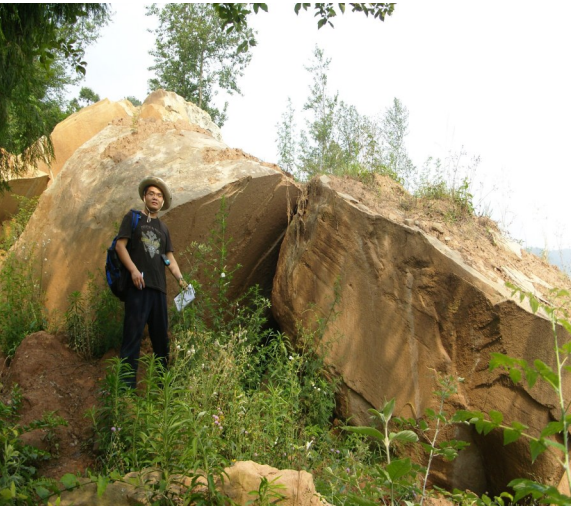
图14 三汇镇危岩已崩落块石
