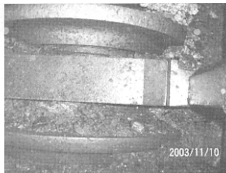
图 2 TBM 刀盘被大量塌落的围岩卡死
