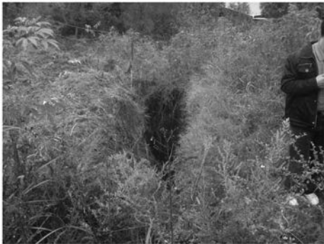
图 3 滑体顶部的裂缝
