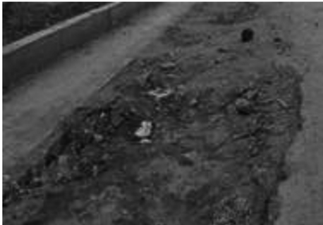
图 1 旧路路基翻浆破坏
