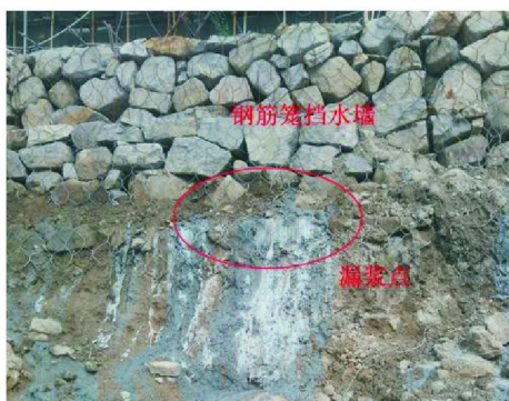
图1 现场漏浆情况
