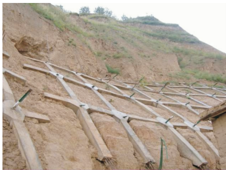
图2 锚索Ⅱ区锚索露出长度现状
