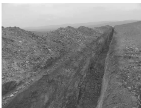
图2 槽探工程对环境的破坏
