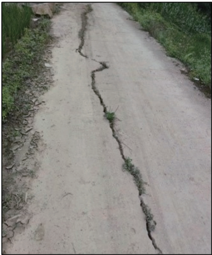
图 8 前缘公路裂缝 Fig.8 Leading edge road crack
