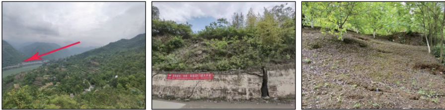
(a) 滑动方向 (b) 滑坡前缘挡墙开裂 (c) 多级台坎、拉张裂缝
