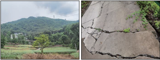
(a) 滑坡后部 (b) 路基塌陷、路面变形开裂
