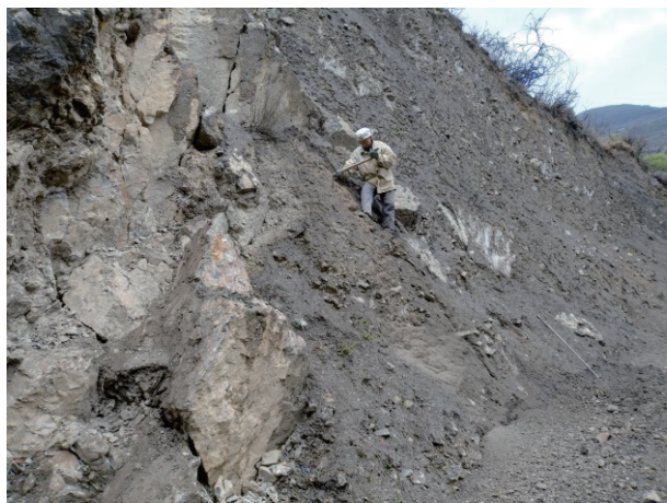
图 12 局部开挖切坡形成高陡临空面
