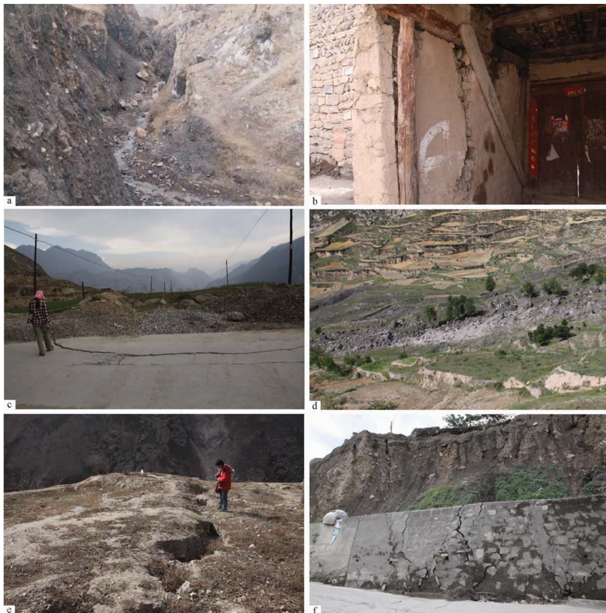
a.滑坡侧壁纵向冲沟中的裂隙水;b.滑坡上段垭头村房屋墙体开裂;c.滑坡中段公路弧形裂缝; d.滑坡体中段碎屑流;e.滑坡前缘弧形拉张裂缝;f.滑坡前缘剪出口挡墙破坏
