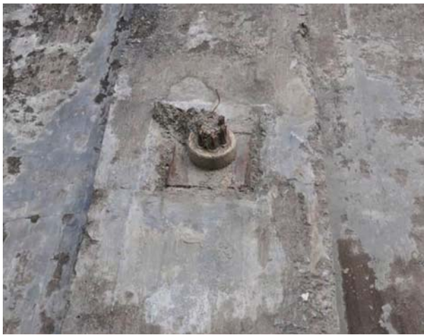
图2 102 滑坡的预应力锚索锚头封锚被破坏
