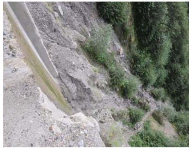
图3 102 滑坡的框架被部分淘蚀悬空
