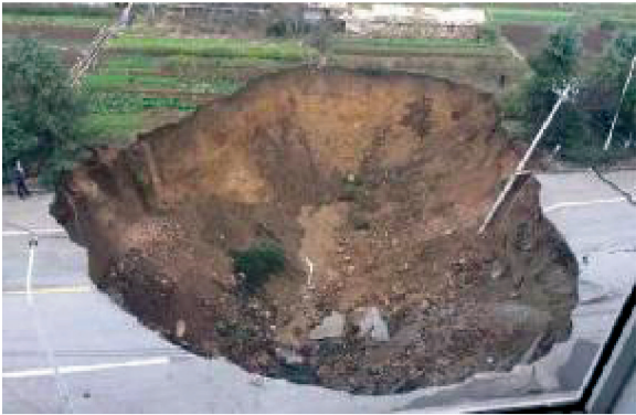
图 1 地面塌陷现场
