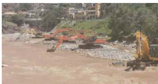
(a) 滑体堆积堵塞河道
