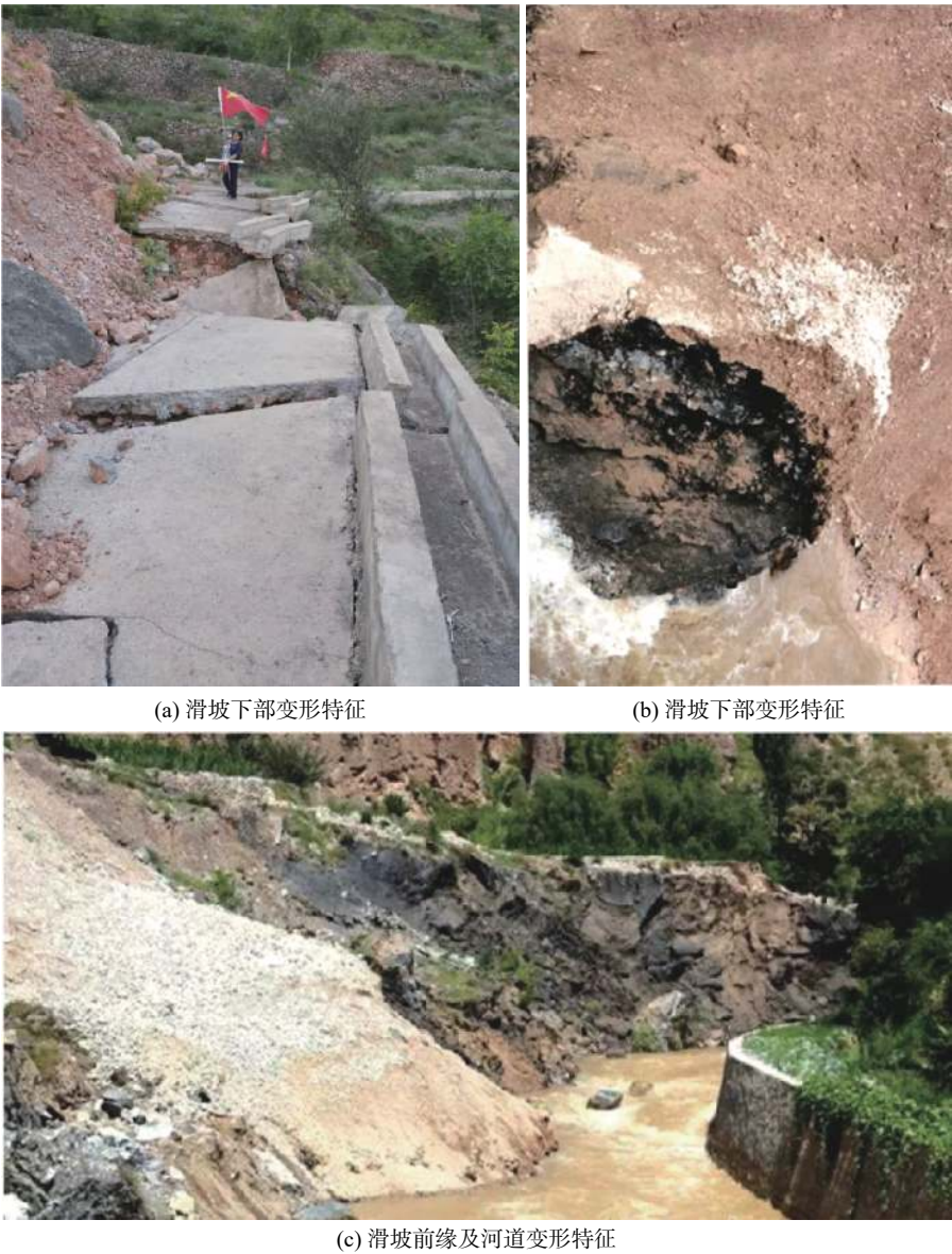
图 4 2019.07.16—22 日垭豁口滑坡变形的证据
