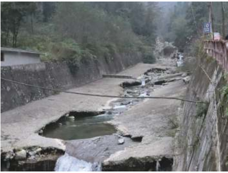
图 5 槽底发生严重损毁
