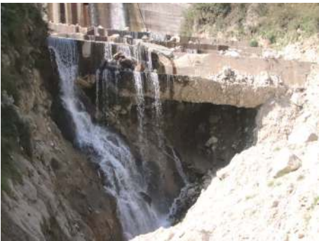
图 3 坝基被流水侵蚀严重
