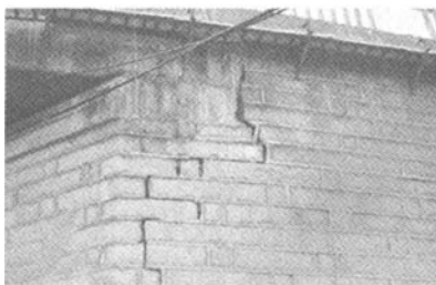
图1 加固前桥台裂缝图
