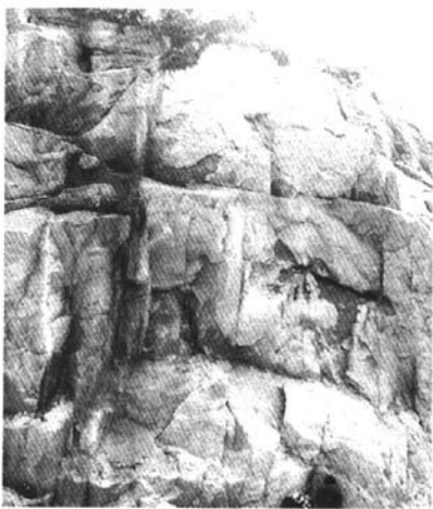
4#边坡中的顺坡向裂隙和陡倾裂隙劈理带
