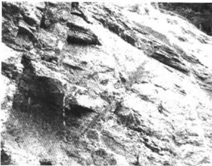
5#边坡中沿顺坡向结构面渗水现象
