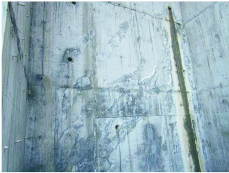
图 2 低位排水孔未有效排水
