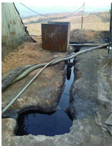
图 11 地表冲洗液循环槽
