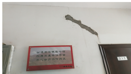
图 1 墙体裂缝照片
